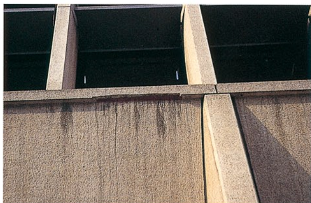
(写真4) 改修前のAIUビル鉄筋の錆から一部コンクリートが剥離している
