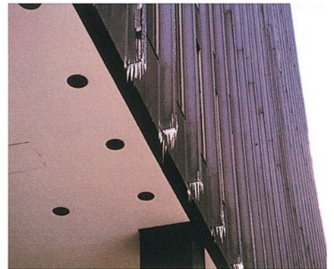
④H鋼の下に成長するつらら
